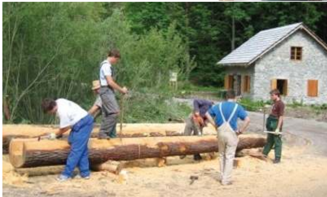
Plešivški mlin – izdelava rač. V lesarski delavnici so bila izdelana tudi okna s polkni in vhodna vrata.
